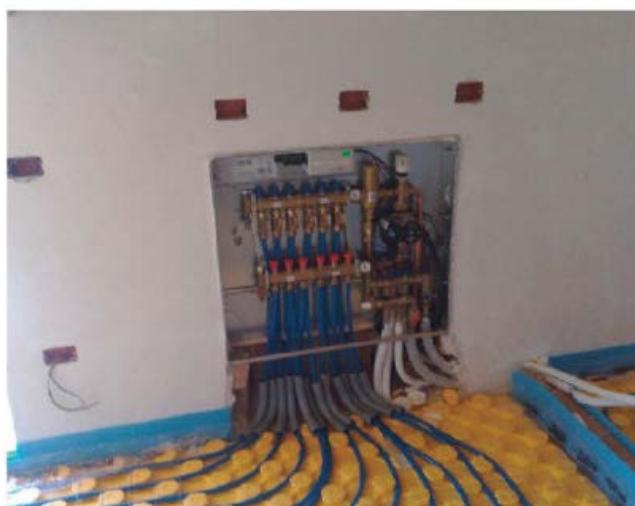
Impianto di riscaldamento a pavimento
